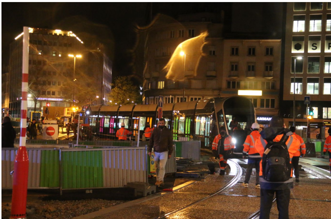
Arrivée du tram à la Gare centrale, © Luxtram
