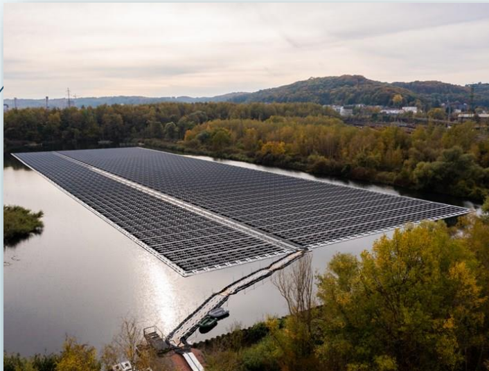
ArcelorMittal Déifferdeng huet déi éischte schwiewend Solarfarm zu Lëtzebuerg
